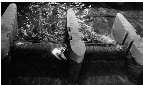
Przepływ przez jaz przy całkowicie podniesionych zasuwach (widok dwóch przesł od stron wody górnej)
