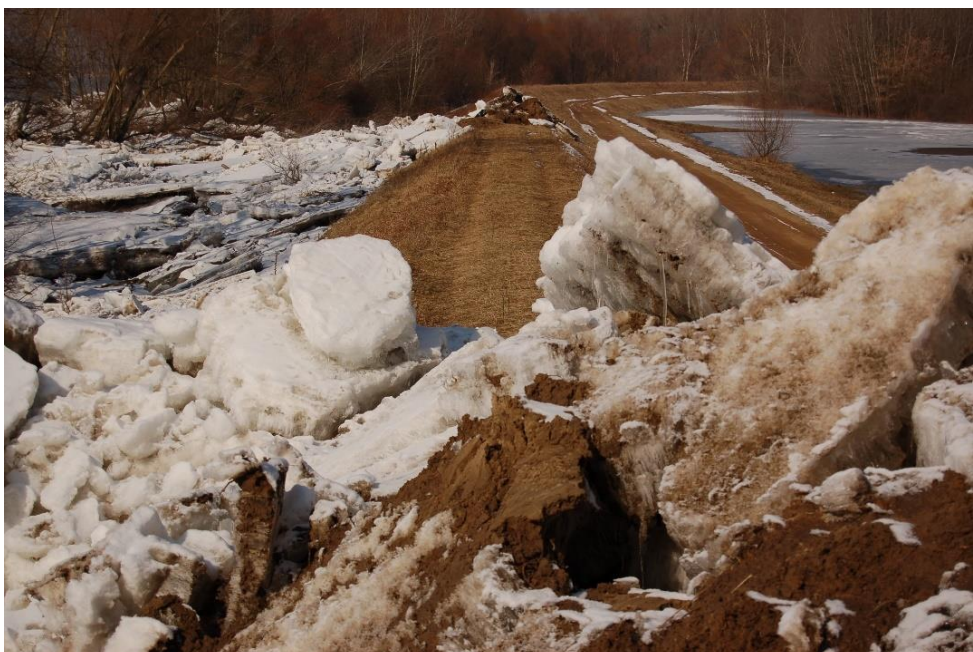
Fot. 5. Wisła (Kępa Polska) – spiętrzona kora uszkadza wał przeciwpowodziowy (fot. IMGW-PIB)
