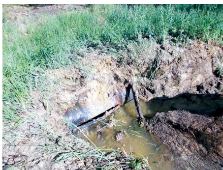
Rys. 2. Pęknięcie szwu wzdłużnego rury stalowej (fot. archiwum własne).
