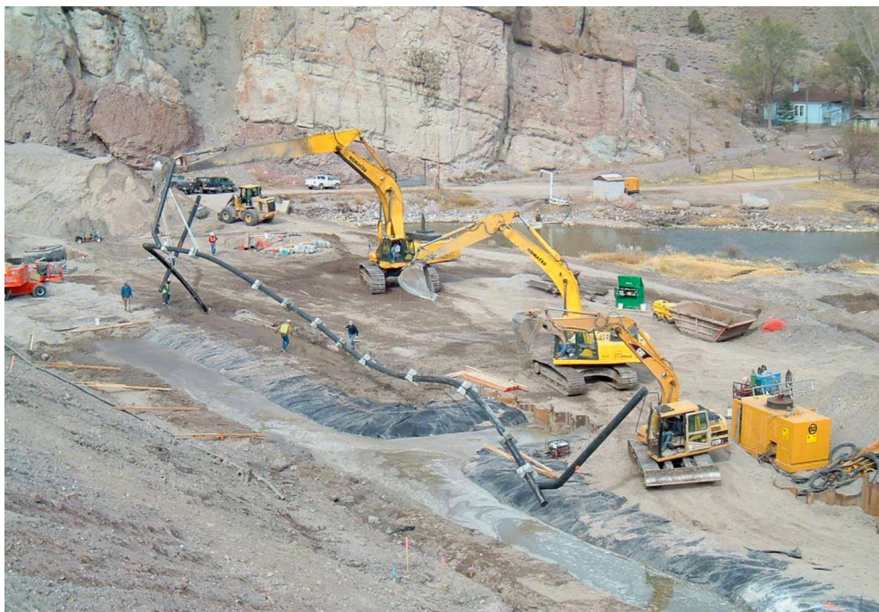
Rys. 4. Układanie studni i rur drenażowych w wykopie rozpiętym zawiesziną polimerową [źródło: https://fransoncivil.com/ ].
