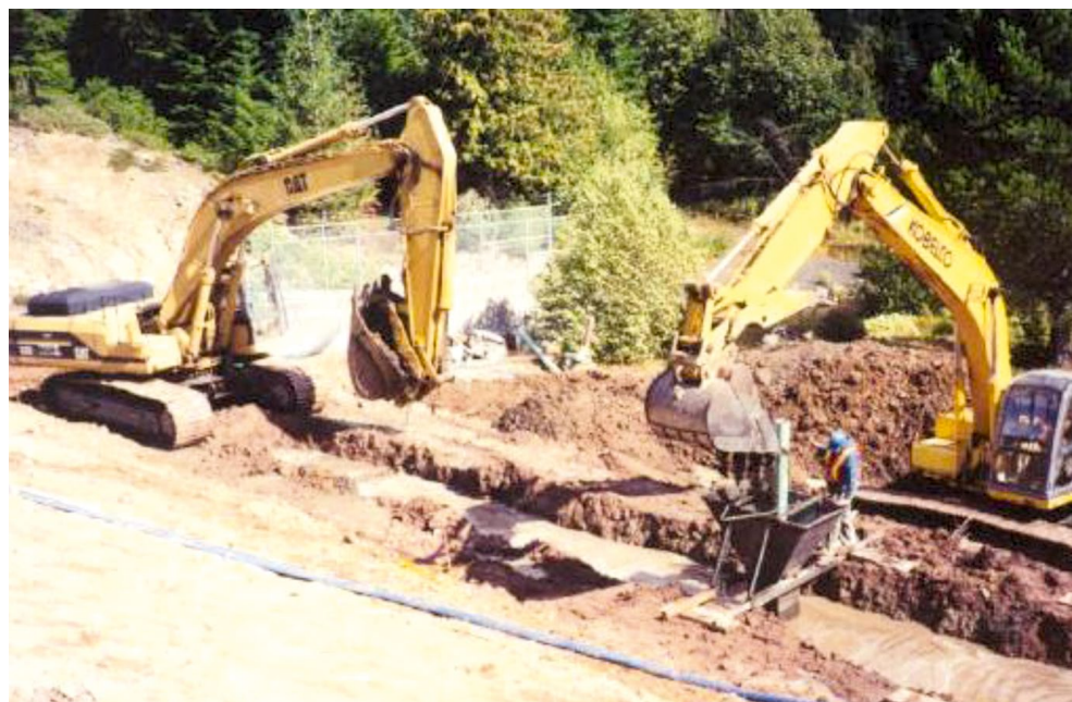
Rys. 8. Realizacja drenażu podskarpowego zapory Wasco z wykorzystaniem zawiesiny polimerowej [Day i in. 2001].
